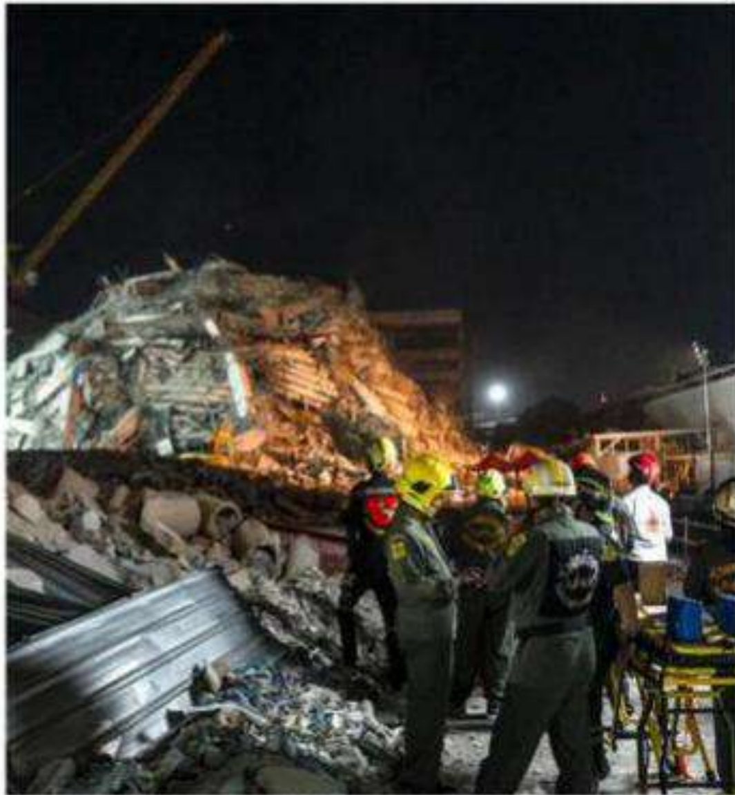
À Bangkok, un immeuble de trente étages en construction s'est écroulé dans un nuage de poussière. (1)
